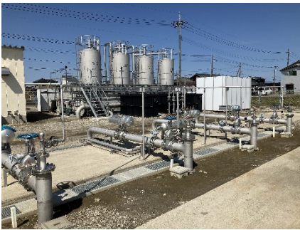
生産設備(採取22基地)
