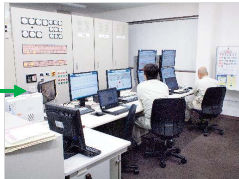
24時間体制の運転状況監視
