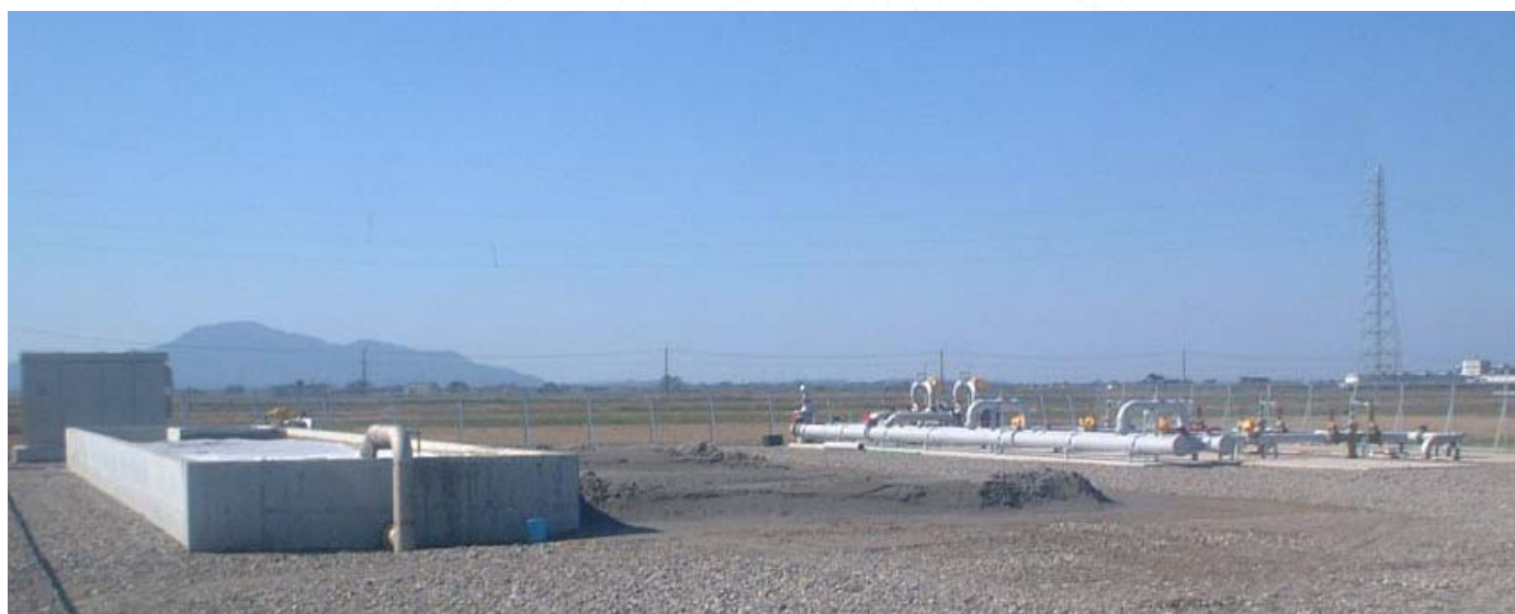
逆洗槽 (砂の沈殿)
