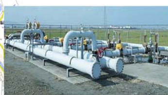
還元設備 (かん水の入れ戻し)
