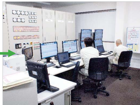
24時間体制の運転状況監視
