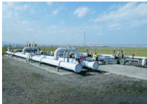
還元設備 (かん水の入れ戻し)
